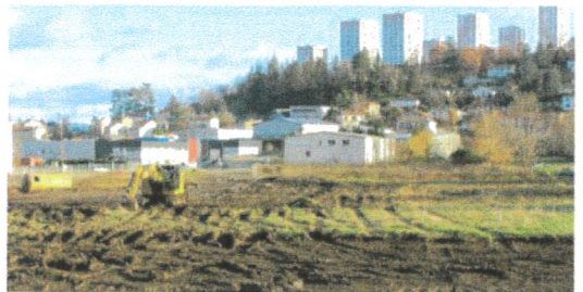
C'est sur les anciennes friches industrielles aujourd'hui rasées que les deux projets de Loire Habitat vont sortir de terre.
